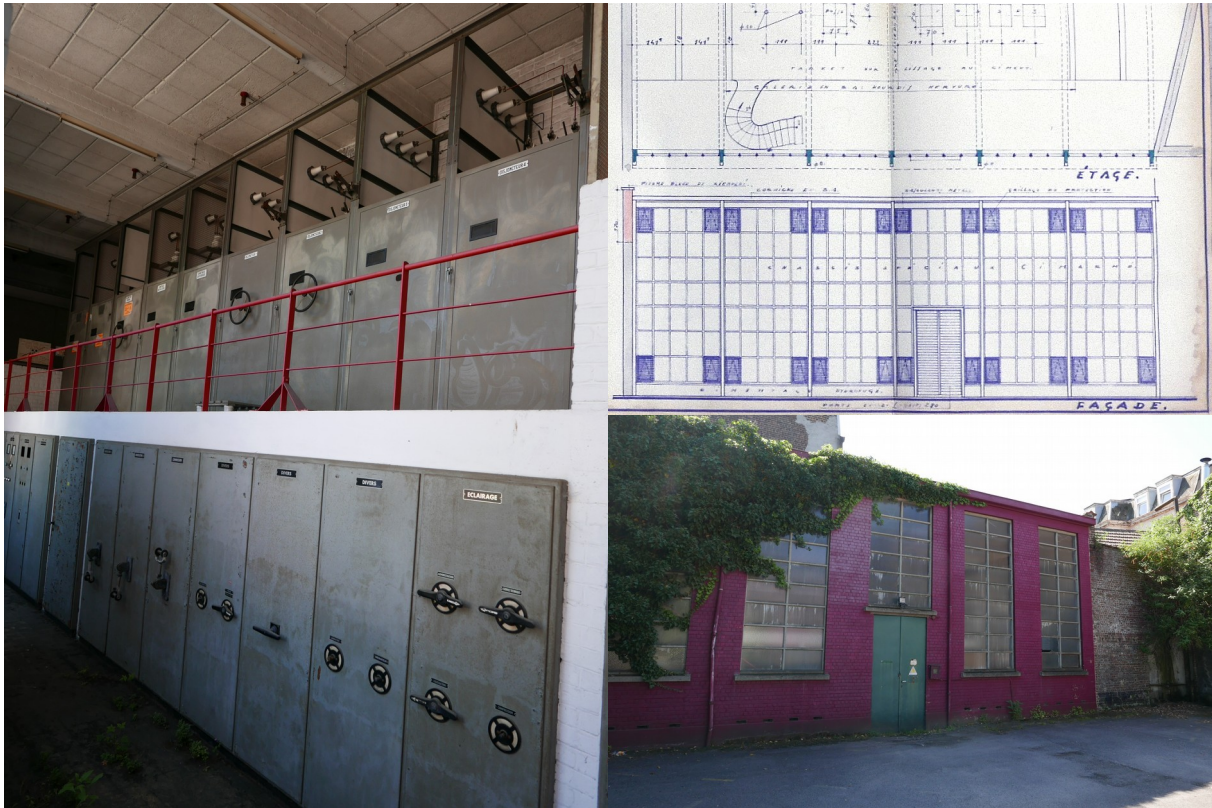
Figure 14: Sous-station électrique construite en 1952. Source : AEB, MTP, PU, Série A, 1597 (1952) et photos personnelles, juin 2019.
