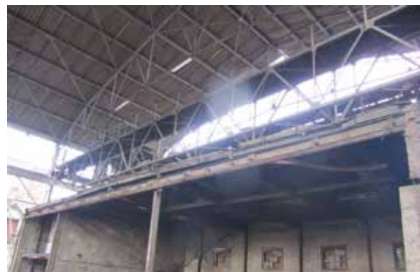
Hangar et pont-roulant, (Photo G. Vanderhulst).
